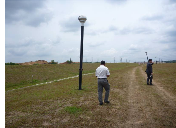
メタンガスのガス抜きをするパイプ。上のプロペラでガスを外に出している。
